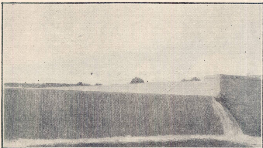
En el canal principal: Salto de desagüe simple para disminuir la pendiente, hay 5 seguidos.—Fot. J. M. Paz
