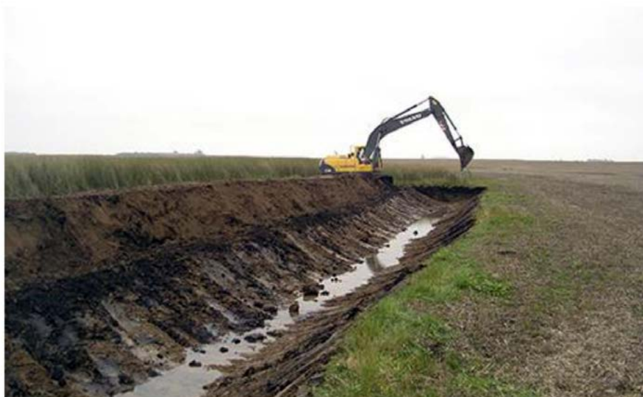
Figura 3. Canales para evacuar el agua hacia cubetas de almacenaje (Tomado de Damiano, 2014).
