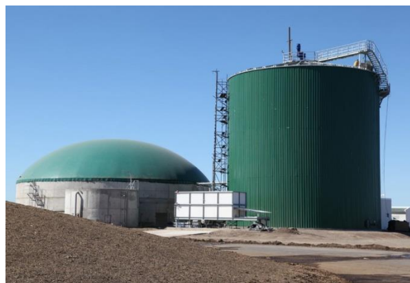
Bioeléctrica Río Cuarto.
