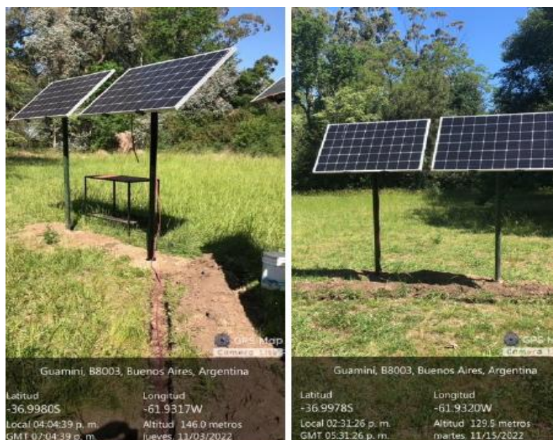
Foto 17. Paneles solares instalados en el establecimiento Organización Juanmil
