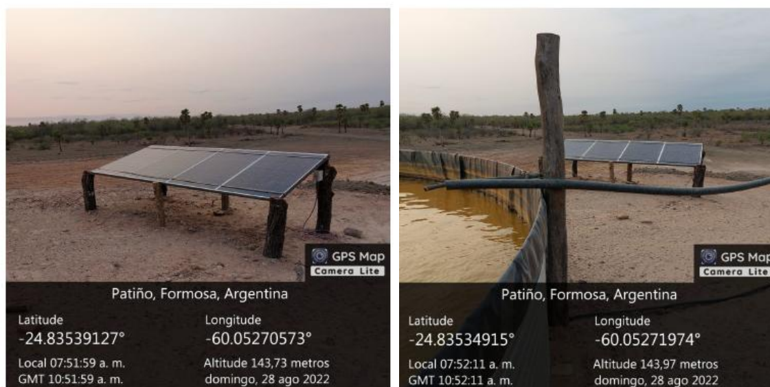
Foto 10. Paneles solares instalados en el establecimiento de Eugenio Allende
